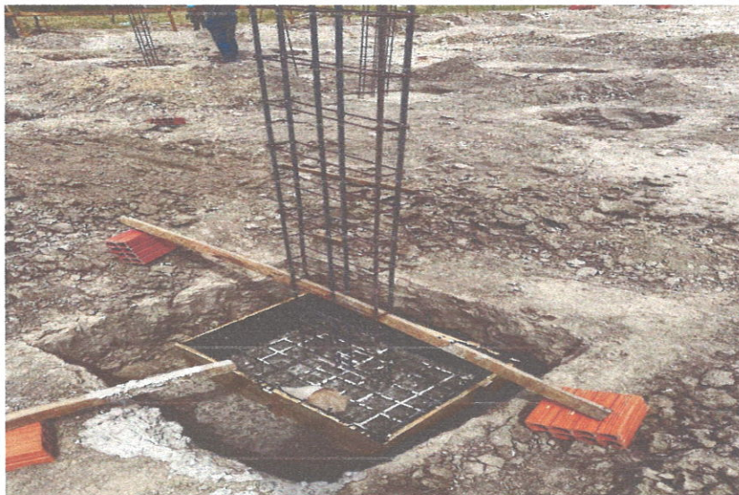
FOTO 8: Montagem de forma para sapatas e aplicação de lastro de concreto magro
